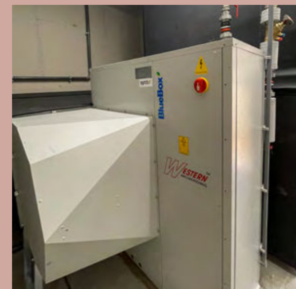
De lucht/water warmtepomp, waarin warmte wordt opgewekt vanuit de lucht en via warm water naar de kerk wordt getransporteerd.
