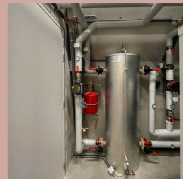
Het buffervat waarin warm water wordt gebufferd
